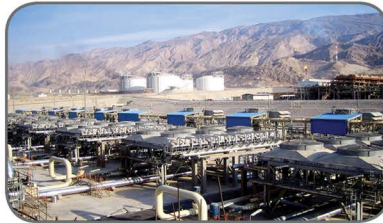
Asaluyeh Booster Gas Compressor
